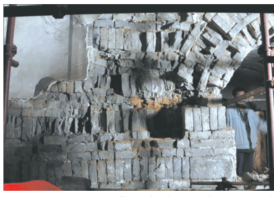
墓室南壁结构失稳修复前
